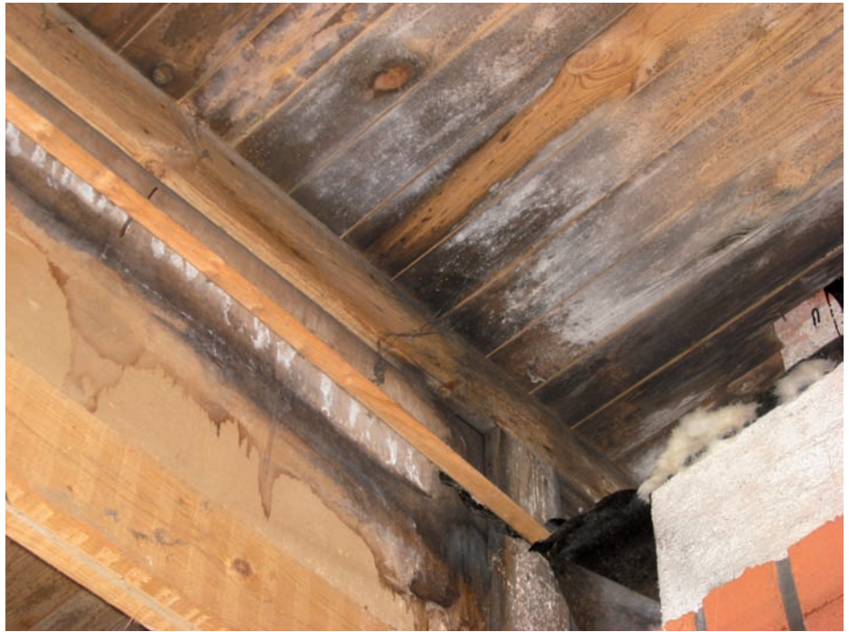
Rivitalossa tasakaton tuuletus ei ole toiminut. Katon ilmanvaihdon puute on johtanut massiivisten mikrobikasvustojen kehittymiseen.
